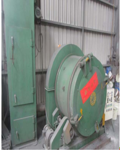
新增集塵器及滾筒式研磨設施
